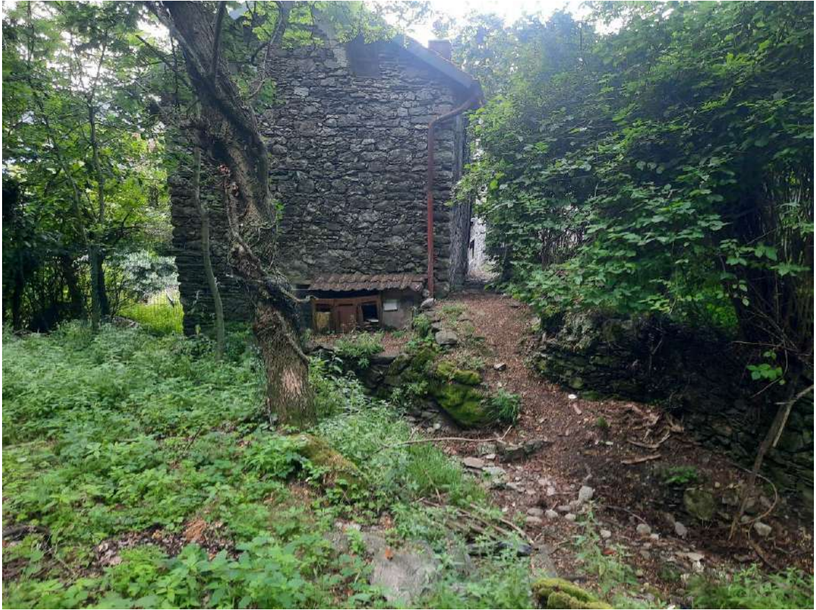
Figura 6 –Valle di Pezzo alveo in corrispondenza dell'ingresso nella frazione di Breglia (particolare). Si noti lo scarso grado di incisione della sponda destra
