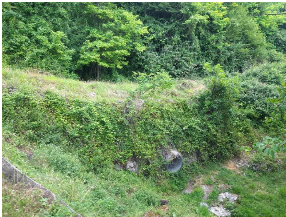
Figura 4 – Tombinatura della Valle di Pezzo in corrispondenza della pista Breglia-Carcente.
