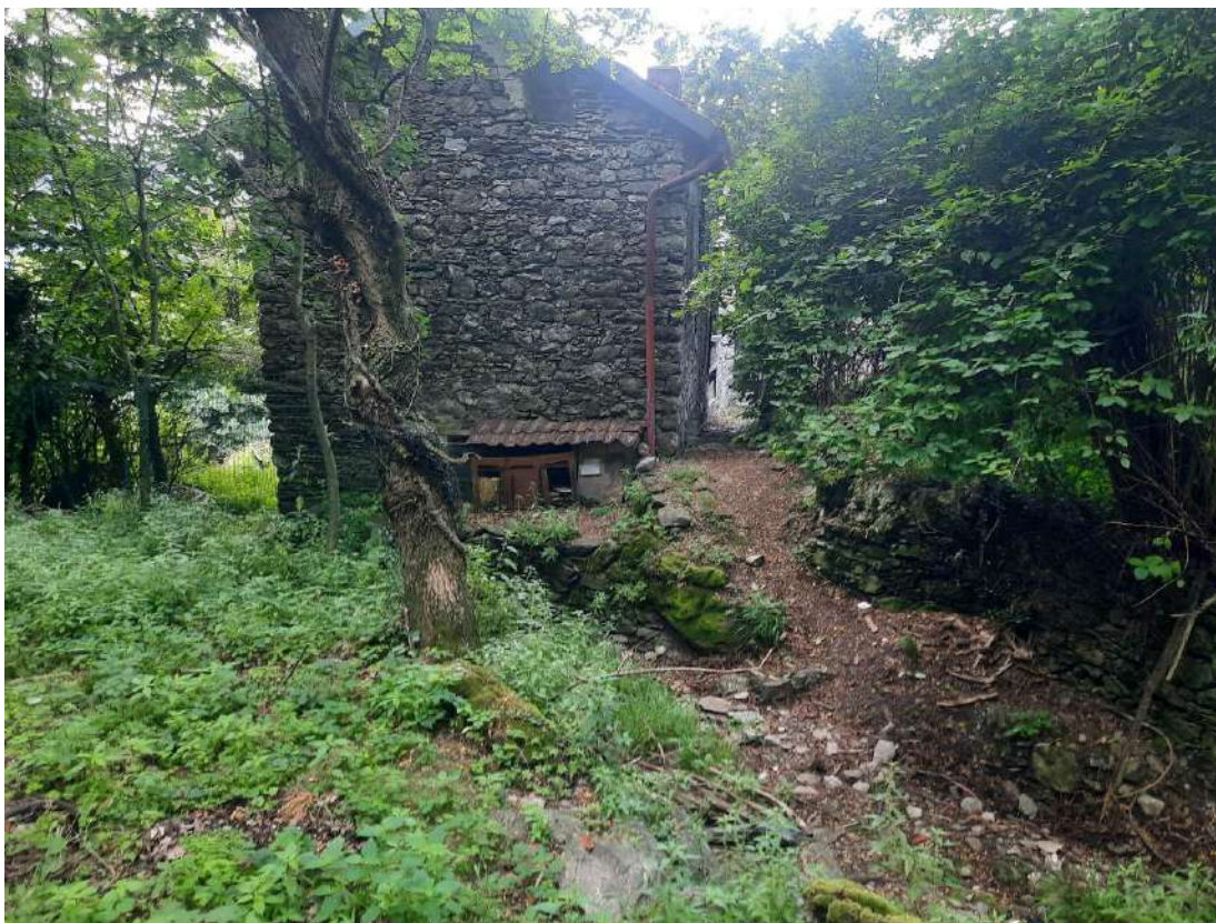
Figura 6 –Valle di Pezzo alveo in corrispondenza dell'ingresso nella frazione di Breglia (particolare). Si noti lo scarso grado di incisione della sponda destra
